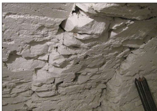
Obr. 7: Žeranovice, zámek, část nezalícovaného klenebního pasu v jižním traktu sklepů s patrným neorganickým připojením kleneb nad východní (vlevo) a západní (vpravo) částí sklepů.
