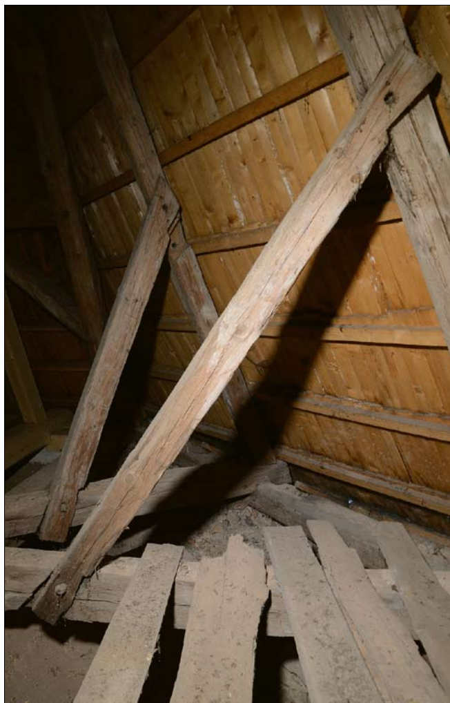
Obr. 10: Miličín, kostel Narození Panny Marie, krov nad presbytářem. Detail krokvi a patních vzpěr zvalbení nad závěrem. Patrné jsou nepřesnosti v plátovém spoji vzpěry a krátčat a prázdný dlab na vzdálenější krokvi.
