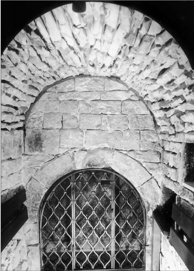
Obr. 3: Praha 1 - Staré Město. Východní stěna zděné šíje domu čp. 451/I v Jilské ulici s částí portálu. Nahoře románská valená klenba, vpravo nika a otvor okénka v jižní stěně. Pohled od západu (foto K. Fink).
