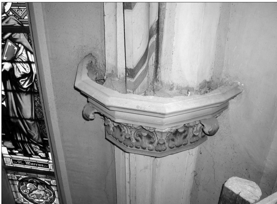
Obr. 50: Žatec, kostel Nanebevzetí P. Marie. Sádrová polygonální košová hlavice v patě klenby závěru presbyteria (severní výběh žebra u osového okna závěru). Hlavice je uchycena drátky a skobami. Podrobným proměřením výběhů žebra a přípoje bylo zjištěno, že musely být odděleny nějakým prvkem, patrně hlavici. Sondáž do vnitřku sádrové hlavice nebyla možná.
