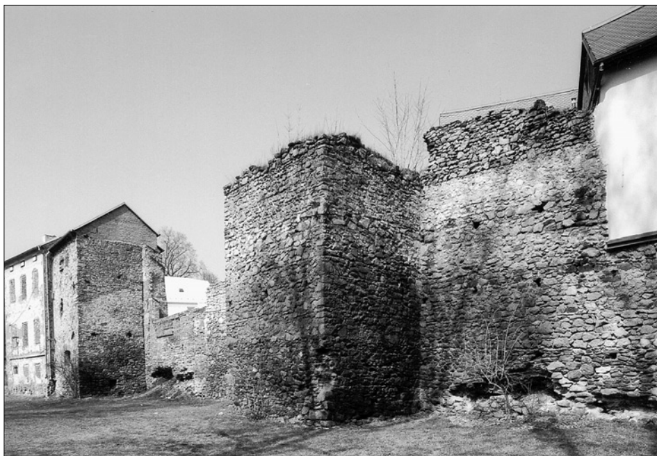
Obr. 38: Tachov, úsek jižní části městského opevnění, pohled od jihovýchodu. Uprostřed věž č. 24, vpravo od ní fragment původní kurtiny s pultovou stříškou skloněnou na městskou stranu (srov. obr. 40). Vlevo v pozadí věž č. 25, připojená v celé své výšce na spáru ke kurtině (snímek z roku 2004, V. Razím).
