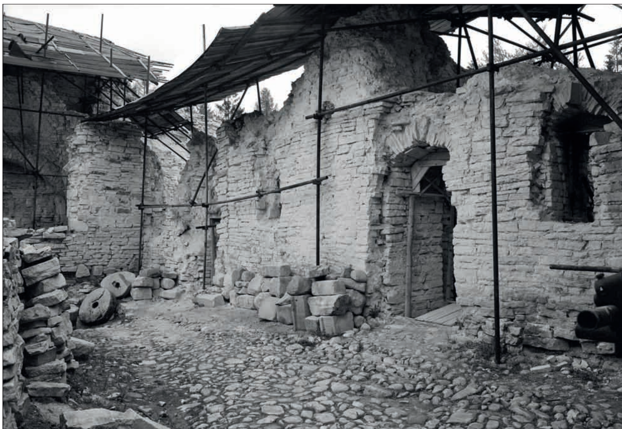
Obr. 115: Nádvoří průčelí východního křídla po začistění plochy nádvoří na valounovou dlažbu. Oproti předešlému snímku (srov. obr. 114) došlo k destrukci záklenku severní místnosti sektoru F a některých dalších partií zdiva (snímek z archivu ÚP NPÚ, asi 1981).
