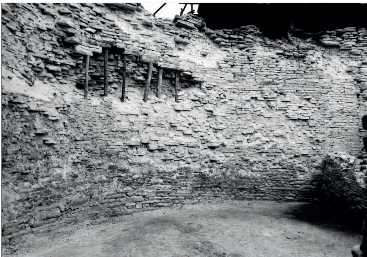
Obr. 144: Líc obvodové hradby v severní místnosti sektoru F, s provizorně zajištěnou jízvou v úrovni druhotně vysekaných lůžek pro stropní trámy. Vpravo zbytek dělicí zdi (snímek ARÚ Praha, asi 1982–1983).
