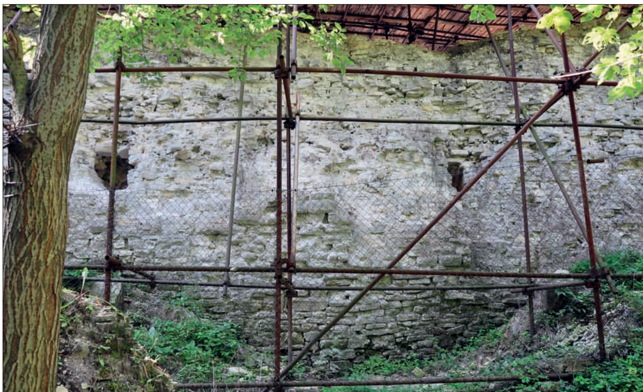
Obr. 64: Silně korodovaná vnější strana obvodové hradby na východní straně jádra (fragment líce se dochoval jen v dolní partii, srov. též obr. 61 zcela vlevo) se dvěma původními okénky v přízemí, třetí uprostřed je zazděno (snímek autor, 2009).
