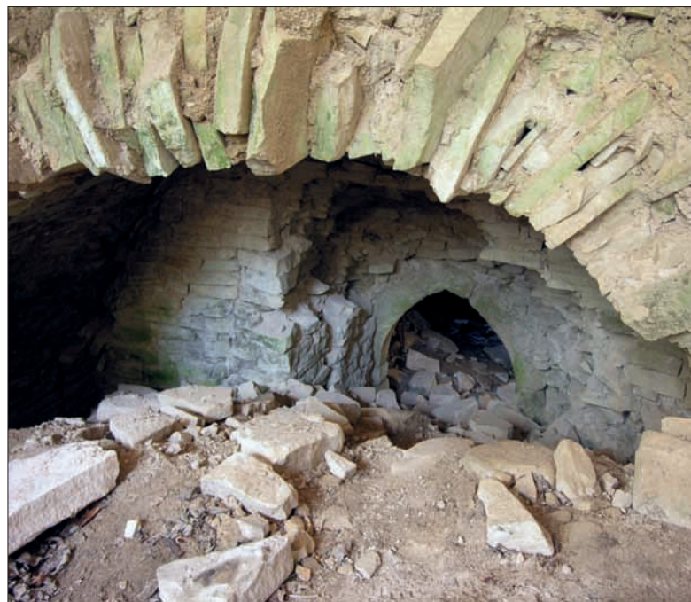
Obr. 75: Průhled částečně zřícenou klenbou do sklepa sektoru C, v pozadí portál průchodu do sklepa pod síní B. Špalety niky vchodu jsou silně destruované (snímek autor, 2007).
