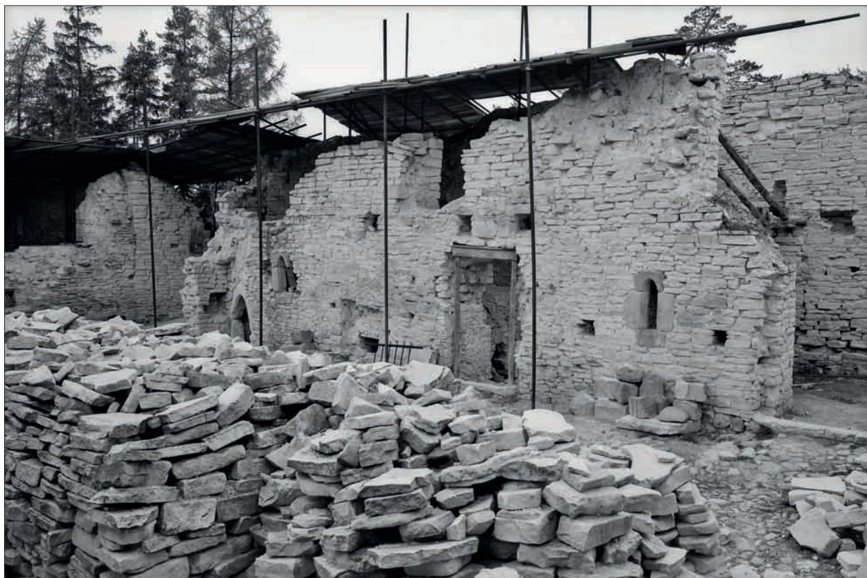
Obr. 147: Nádvoří průčelí západního křídla v pohledu od sv. Část zdi 1. patra nad lomeným okénkem vpravo, která se později zřítla, je zajištěna šikmými vzpěrami. V popředí sklad kamene v prostoru nádvoří, s nímž se počítalo na opravy. Záklenek nad vstupem do sklepa (v pozadí, srov. obr. 146) již neexistuje (snímek z archivu NPÚ ÚP, asi 1980).
