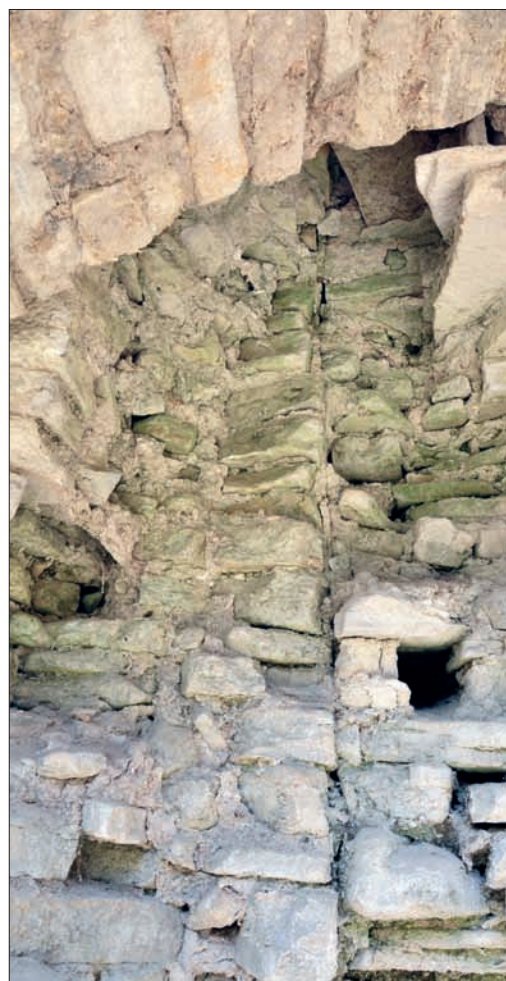
Obr. 168: Detail svislé spáry (srov. obr. 167) v hradbě pod severním obloukem kuchyně (snímek autor, 2012).
