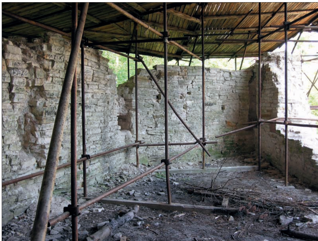
Obr. 89: Současný pohled do západní části jižní síně B, s vytrhanými klenebními konzolami a stopami devastace (snímek autor, 2006).
