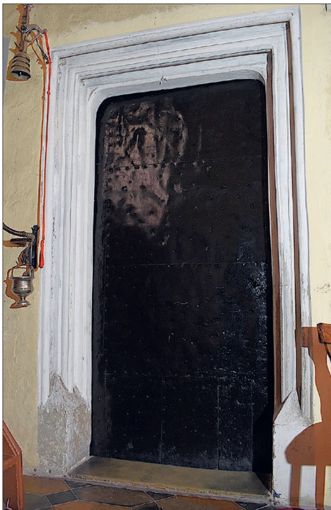
Obr. 18: Poděbrady, kostel Povýšení sv. Kříže. Portál vstupu do sakristie se zevně oplechovanými dveřmi. Dveře vyrobeny roku 1671, jak by měla svědčit cedulka z roku 1875, schovaná za oplechováním (stav 2024).
