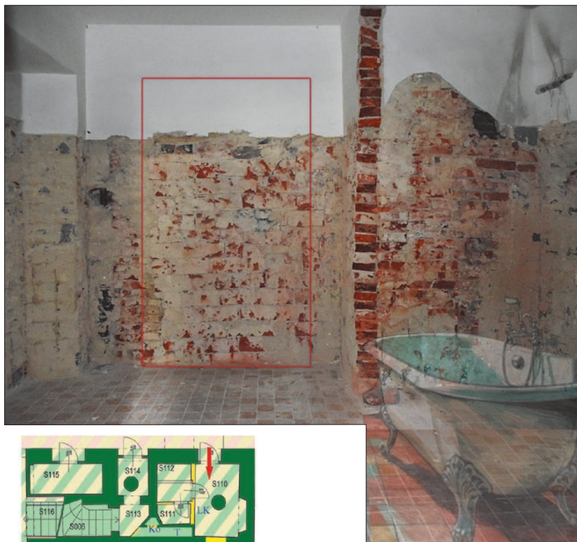
Obr. 22: Františkovy Lázně, dům čp. 5, lázeňská koupelna v přízemí. Vpravo v nice stála vana určená ke koupeli v minerální vodě, uprostřed zazděný vstup z lázeňského pokoje (foto L. Zeman, 2024).
