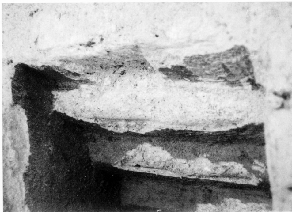
Obr. 8: Detail stupňovitého nadpraží vnější špalety jednoho z okének Velké věže. Pod recentní omítkou s pravouhlymi nárožími se dochovala pozdně gotická omítka s měkkým zaoblením na hranách. (Foto autor, květen 1993)
