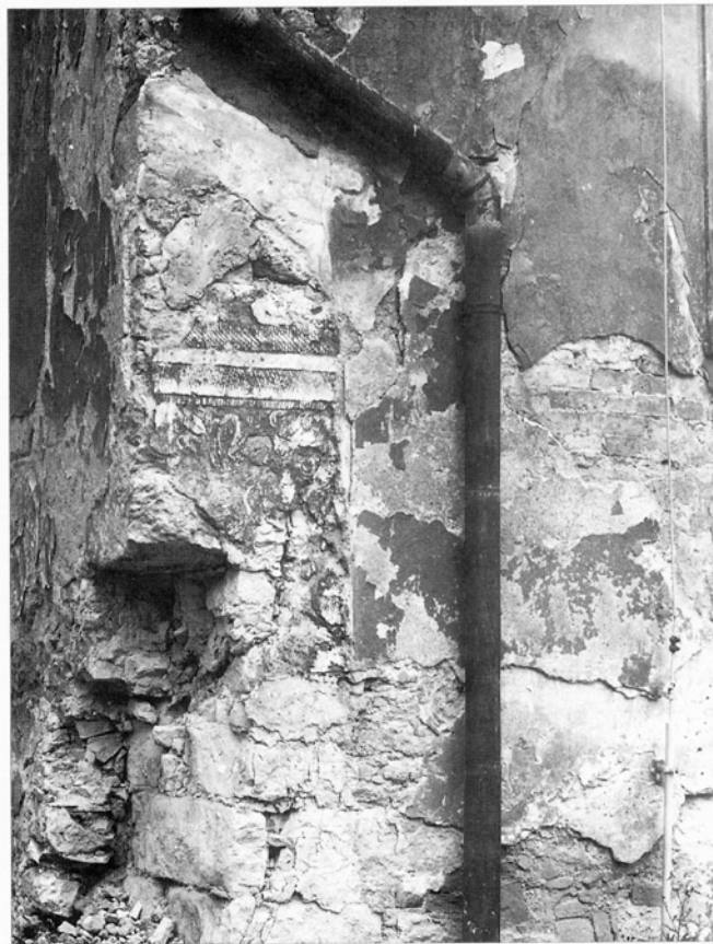
Obr. 15: Košátky, detail sgrafita odhaleného pod odbouranou zdí na jižním průčelí zámku. (Foto autor.)
