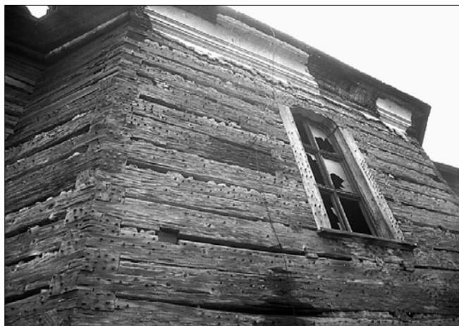
Obr. 4: Roubení na severní stěně lodí s trčícími kolíčky, které sloužily k uchycení hliněné omazávky (jsou i na většině čelních ploch zárubně okna). Nahoře jediný zbytek původního povrchu - na posledním trámu stěny hliněná mazanina s omítkou a nahoře jenom omítka, tvořící definitivní profil římsy.
