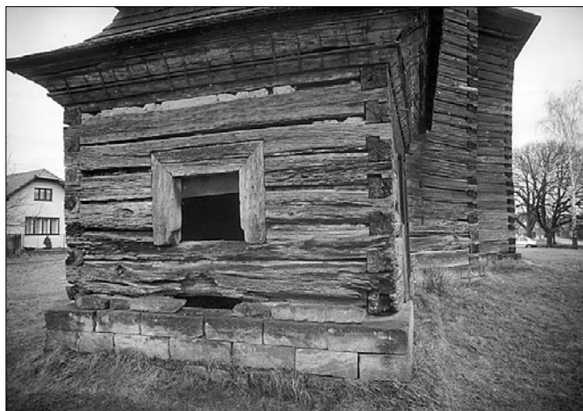
Obr. 3: Západní stěna předsíně s porušeným roubením na podezdívce z pískovcových kvádrů, s neúplnou zárubní okna. Na hrubém polotovaru římsy s hlavním fabionovým profilem provedeným z rozbitého, našťipáného prkna, je patrný rastr přibitých štěpin, sloužících k uchycení omítky. Pod spodním trámem roubení jsou zbytky vyzdívky, vyrovnávající výškovou diferenci oproti níže položeným trámům podélných stěn.
