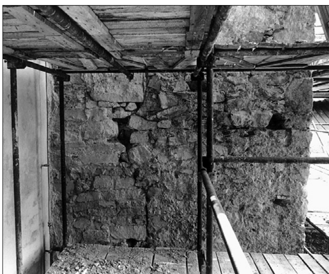
Obr. 4: Kostel Pozdvížení sv. Kříže v Pyšelicích, jižní část západní stěny kostela, viditelná spára oddělující románské zdivo (vlevo) od gotického (vpravo). (Snímek P. Kroupa.)
