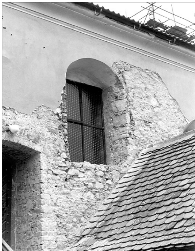
Obr. 10: Dodatečně prolomené otvory v jižním průčelí lodi. (Všechny snímky autor.)
