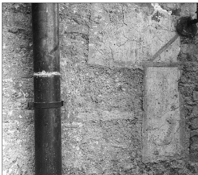
Obr. 11: Líšno - severní průčelí zámku, část pozdně gotického nárožního kvádrování s červenými linkami na obvodu a navazující hrubá omítka s vykvetovanými pásy plošného iluzivního kvádrování, stav 1992. Foto autor.
