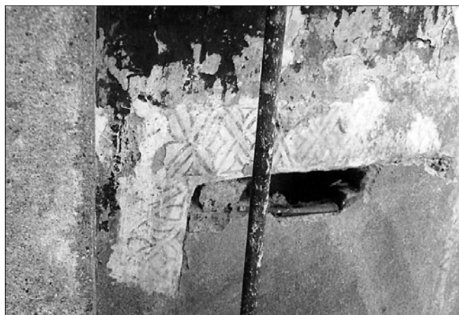
Obr. 13: Měchnov - kostel sv. Martina, nadpraží s pozdně gotickou ornamentální malovanou paspartou okenního otvoru, odhaleného na jihu apsidy. Stav 1992. Foto autor.
