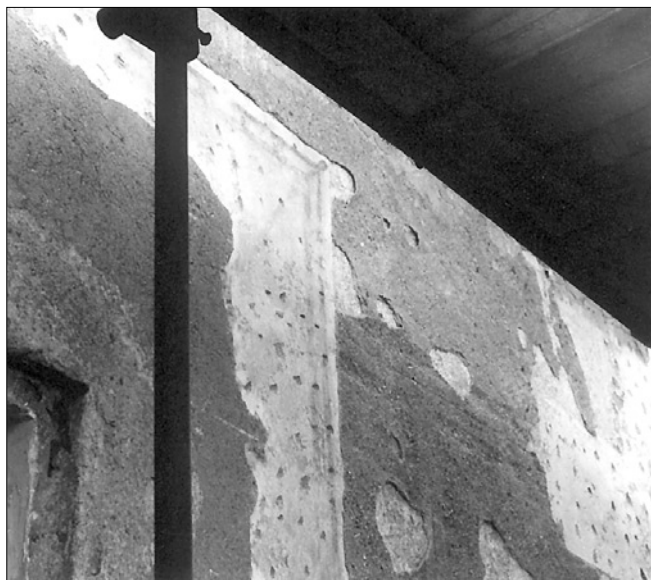
Obr. 10: Komorní Hrádek - severní průčelí starého zámku, část pozdně gotické pasparty s červenými linkami a nárožního kvádrování (zcela vpravo) a překrývající vrstva renesanční sgrafitové omítky (nalevo od pasparty patrné ryté linky obdélníků), stav z roku 1993. Foto autor.
