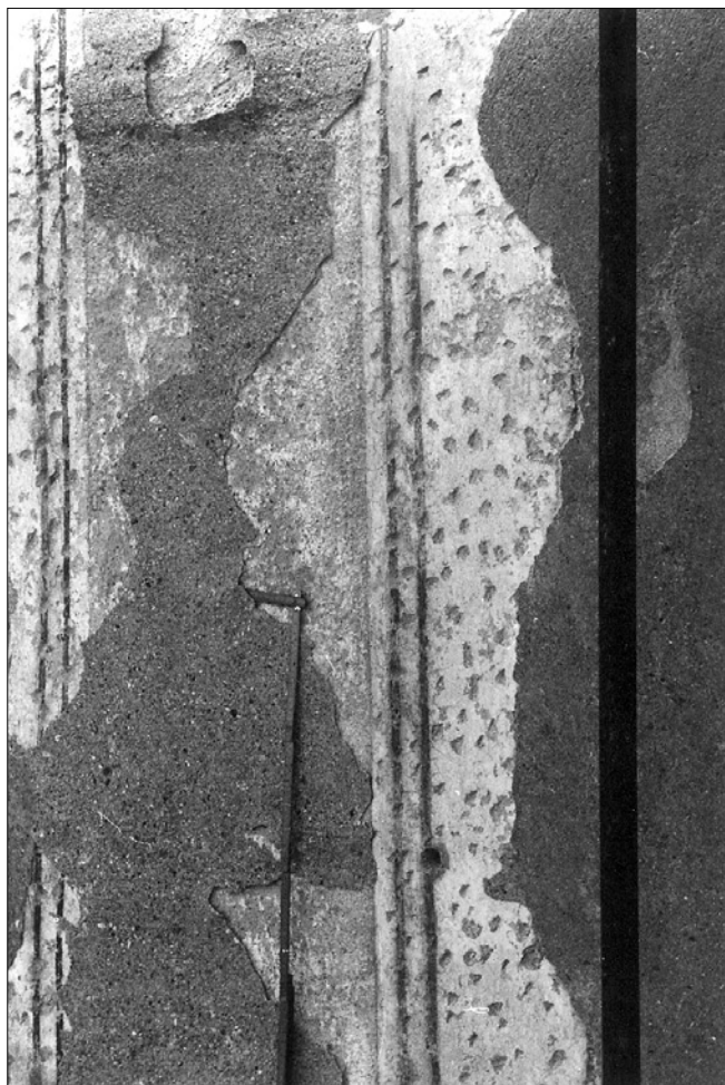
Obr. 15: Komorní Hrádek - severní průčelí starého zámku, mezera hrubou omítkou mezi pozdně gotickými paspartami původních oken. Stav 1993. Foto autor.
