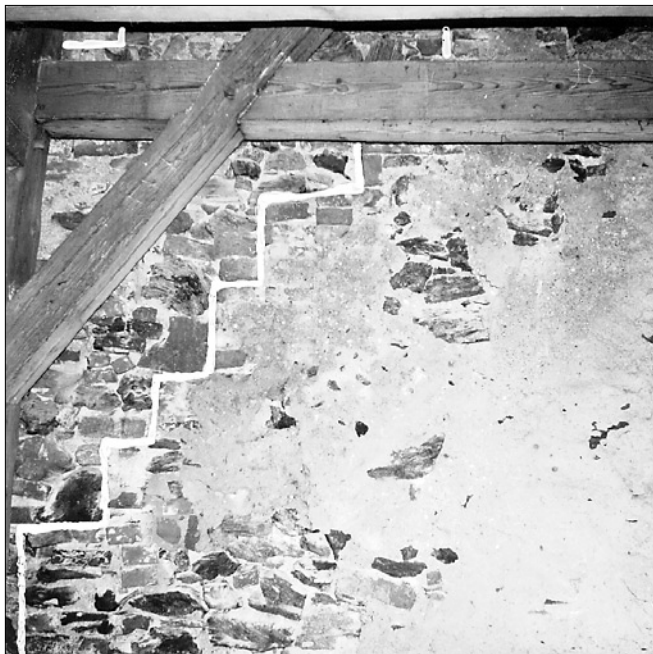
Obr. 18: zazděný úsek nižšího stupňového štítu (poloha je vyznačena na obr. 16). Na štítu je částečně zachována původní gotická jednovrstvá omítka s typickými četnými zrny nevyhašeného vápna.
