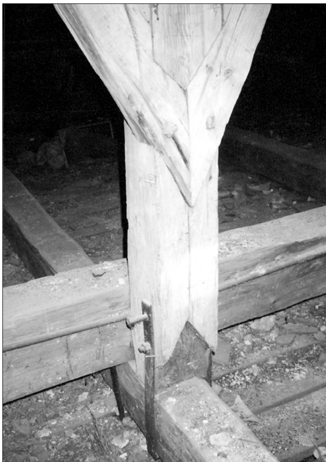
Obr. 13: Heřmaň, kostel sv. Jiljí. Detail spodní části sloupku krovu lodi s neobsazeným dlabem pro další prvky podélného ztužení (foto J. Varhaník, 1996).
