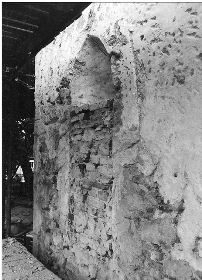
Obr. 9: Heřmaň, kostel sv. Jiljí. Osově okno závěru s nevelkým úsekem dochované omítky, poškozené pekovaním (rýha podél hrany špalety vznikla při odstraňování novodobé omítky, nejde o pozůstatek pasparty či jiné historické úpravy), (foto J. Varhaník, 1996).
