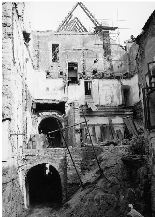
Obr. 1: Plzeň čp. 138, havarovaná nádvorní partie domu.
