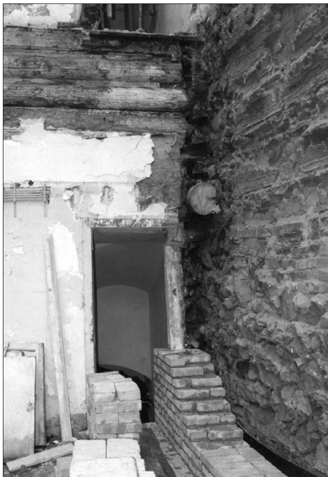
Obr. 7: Plzeň čp. 138, severovýchodní kout srubu po odstranění trosek.
