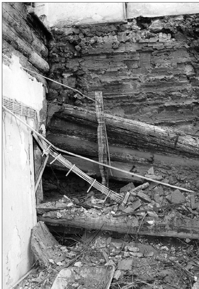
Obr. 5: Plzeň čp. 138, pohled na část havarované východní stěny srubu.
