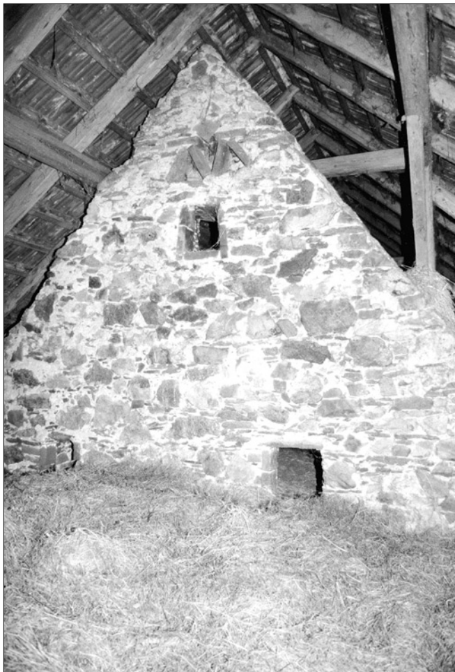
Obr. 19: Krnín, čp. 1. Pohled na čelní stěnu štítu středověké sýpky (?) dochovaného pod střechou jižního stavení. V horní části je patrný ornament z režných cihel.
