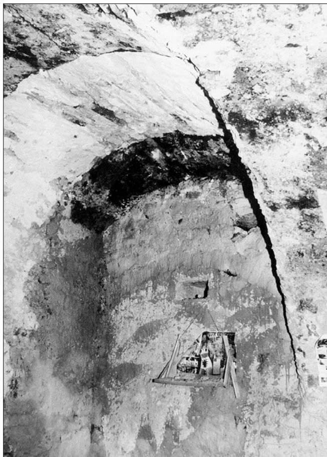
Obr. 16: Krnín, čp. 1. Pohled do interiéru mladší černé kuchyně - nahoře zastěpený otvor dymníku, ve stěně zaústění sopouchů pod segmentovým záklenkem.
