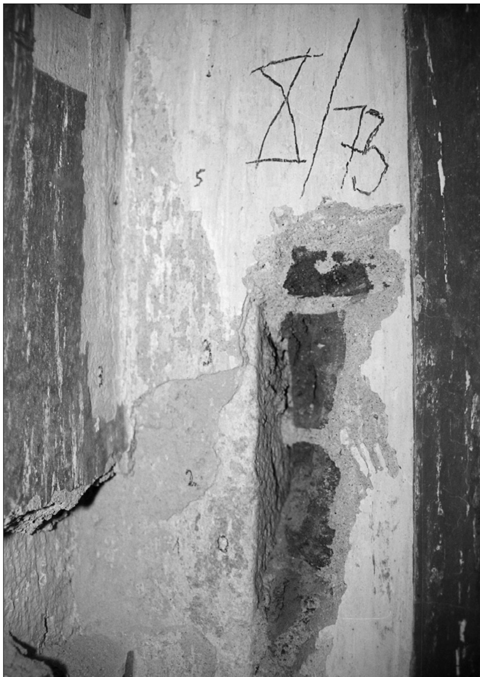
Obr. 5: Jaroměřice nad Rokytinou, zámek - západní malé nároží, styk s jižním křídlem - složitá nálezořová situace odhaluje původní nároží starší stavby a silné vyrovnávací pleny pozdější (červené) úpravy (foto autor).
