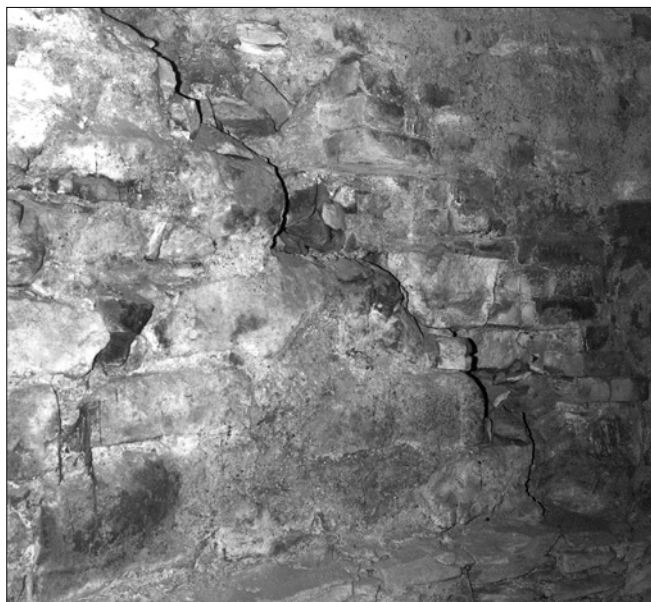
Obr. 15: Jizva v severní stěně interiéru věže při jihozápadním nároží kostela sv. Mikuláše. Úroveň druhého podlaží, pohled od jihu (foto Václav Novák, 1998).
