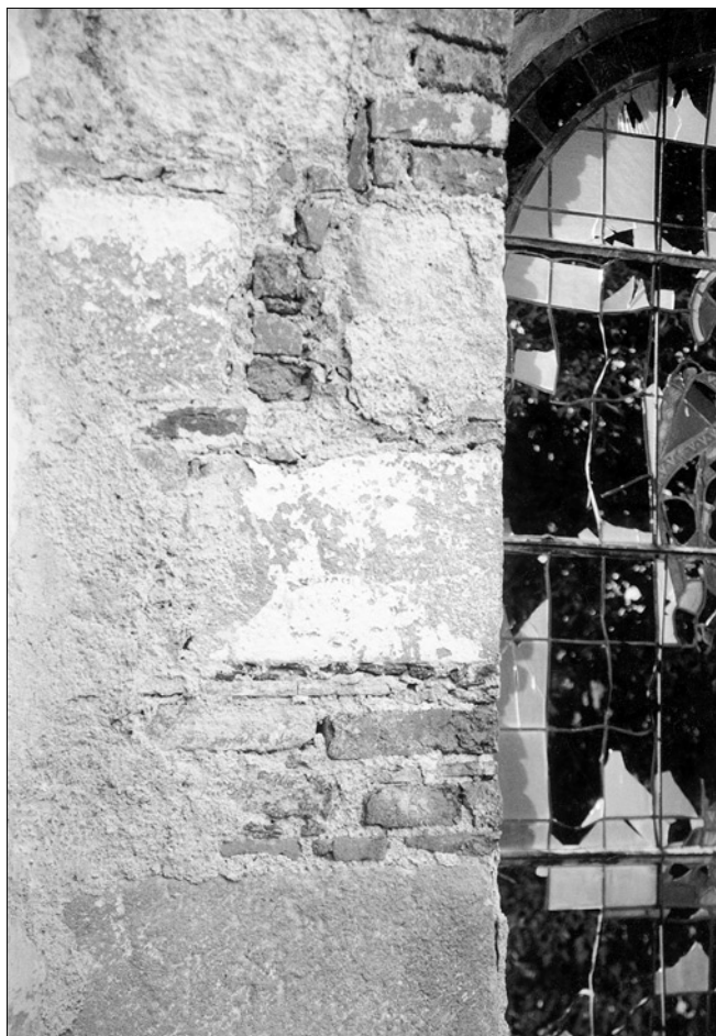
Obr. 9: Kostel sv. Prokopa v Lestkově. Hladce opracované kvádry s obílenou plochou zasazené druhotně ve zdivu lodi, které patrně pocházejí ze starší románské stavby.
