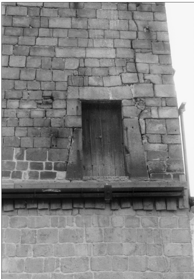
Obr. 10: Telč, kostel sv. Ducha, západní stěna, vstupní portál, horní část zdiva před opravou, spodní po provedeném statickém zajištění.
