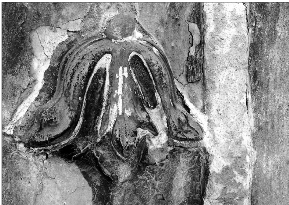
Obr. 14: Český Krumlov, dům čp. 32, severní průčelí, terakotový zvoněk jako součást původního květinového festonu klasicistní výzdoby objektu.
