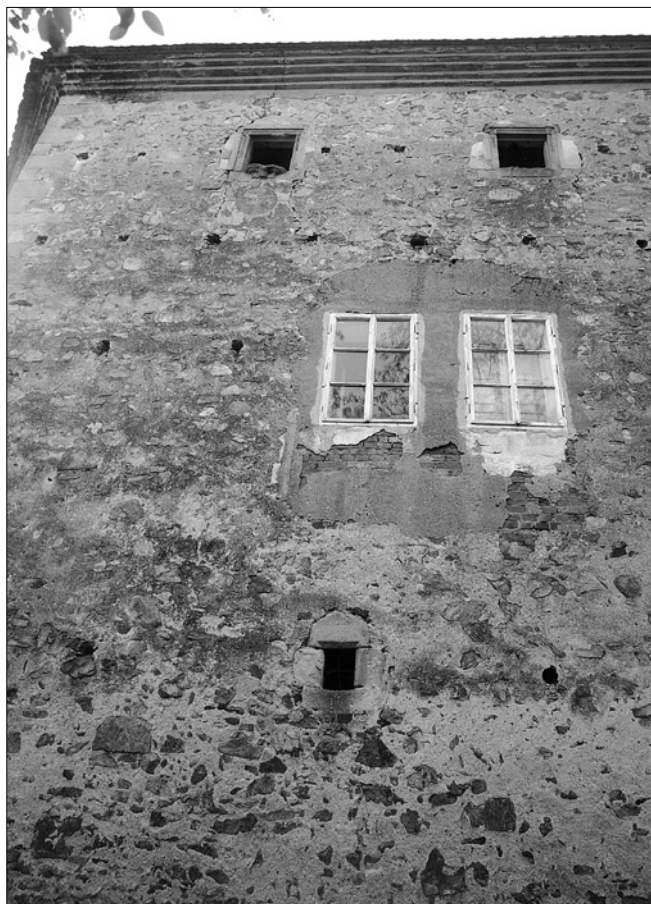
Obr. 13: Roupov hrad, severní bašta předhradí, severozápadní stěna.
