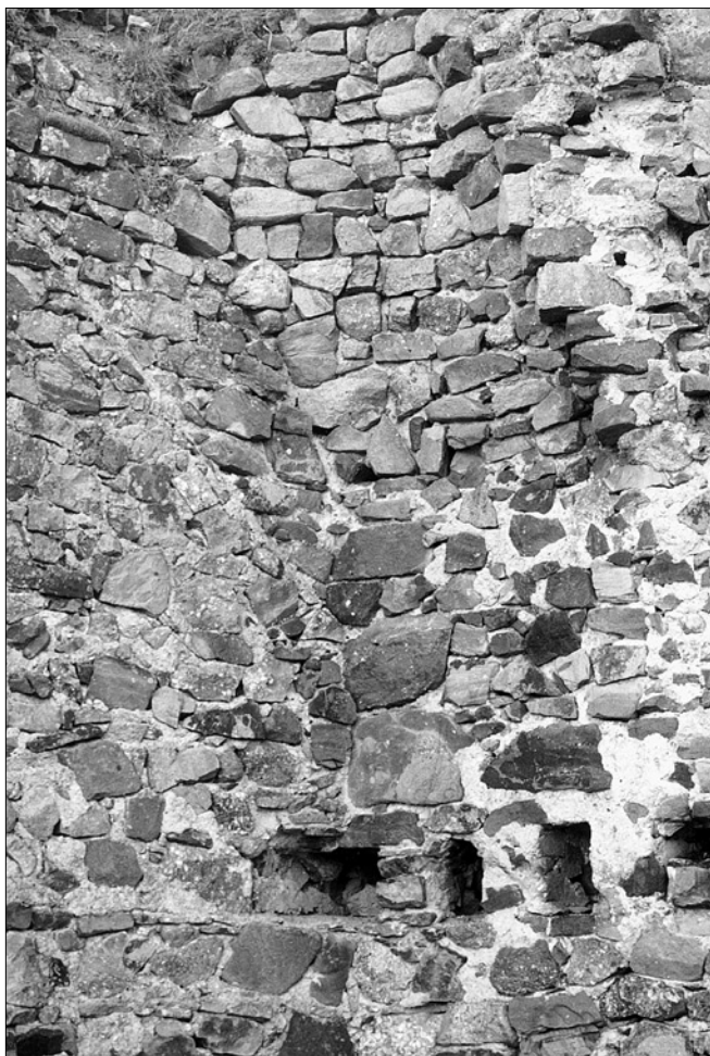
Obr. 17: Valdek, detail jihovýchodního rohu interiéru paláce. Krajiní lůžko trámu stropu 1. patra svým zahlobením do líce východní zdi dokazuje současný vznik stropu se střešním štítem. Spára štítu vlevo nahore (foto autor, 2000).
