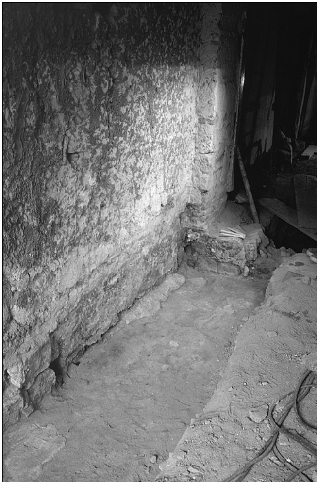
Obr. 14: Plzeň, čp. 126. Pozůstatky zaniklé místnosti odkryté v přední části příjezdu (podlaha, omítka, přička), pohled od východu (foto R. Široký, 1999).
