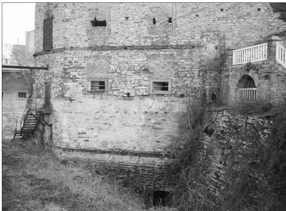
Obr. 16: Nové Město nad Metují, západní průčelí bašty. Pod okny 1. patra patrná řada cihelných zazdívek lešenových otvorů, v pravé části 1. patra otisk odbourané hradby. V úrovni 2. patra otisk střechy staršího mostu do zahrady (foto J. Slavík).
