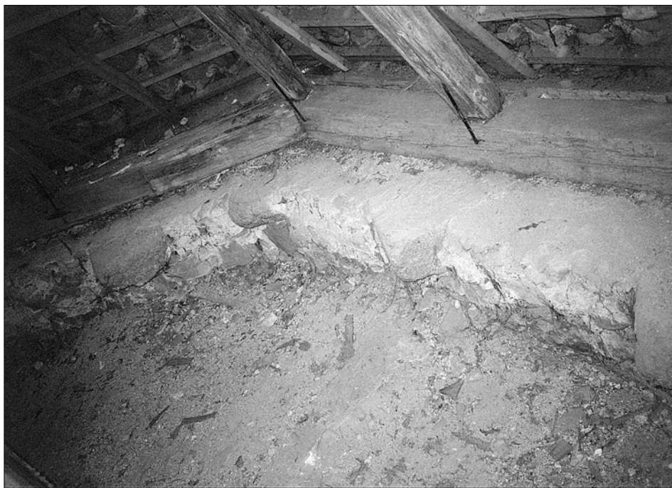
Obr. 4: Kostelec nad Vltavou, kostel Narození P. Marie, koruna zdiva závěru s konzolovitě vyloženými prvky nad rubem klenby.
