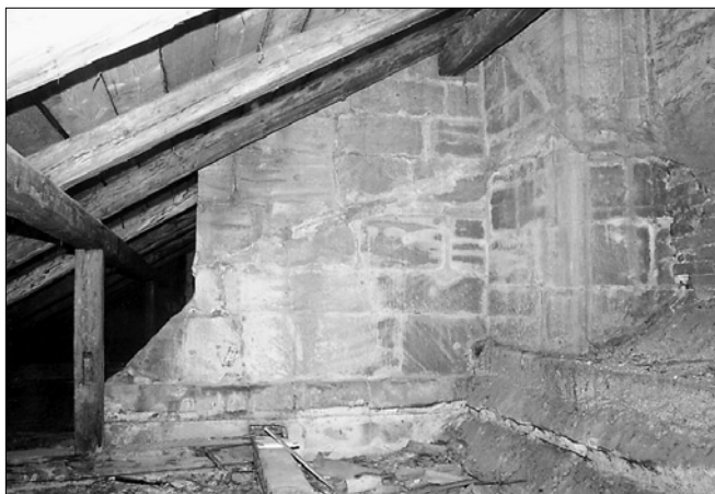
Obr. 15: Chrudim, kostel Nanebevzetí P. Marie. Podstřeší jižního přístavku kněžiště. Detail okna závěrového pole a přilehlého opěráku s otisky dvou starších střech. Pohled od východu.
