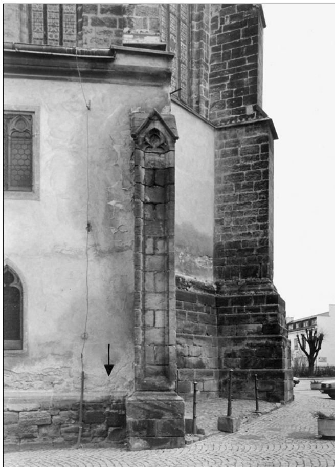
Obr. 8: Chrudim, kostel Nanebevzetí P. Marie. Nároží jižního přístavku kněžiště v pohledu od jihu (srov. obr. 7). V popředí opěrák ze Schmoranzovy rekonstrukce, vlevo od něj sokl se stopou návaznosti staršího opěráku (označena šipkou). Mocnost východní zdi přístavku naznačuje také podoba jeho okapní římsy.
