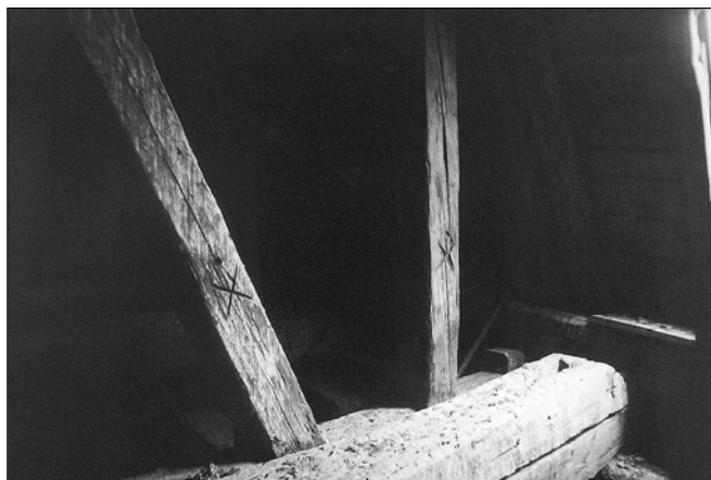
Obr. 7: Chrudim, kostel Nanebevzetí P. Marie, detail číslování severních vzpěr v 15. vazbě.
