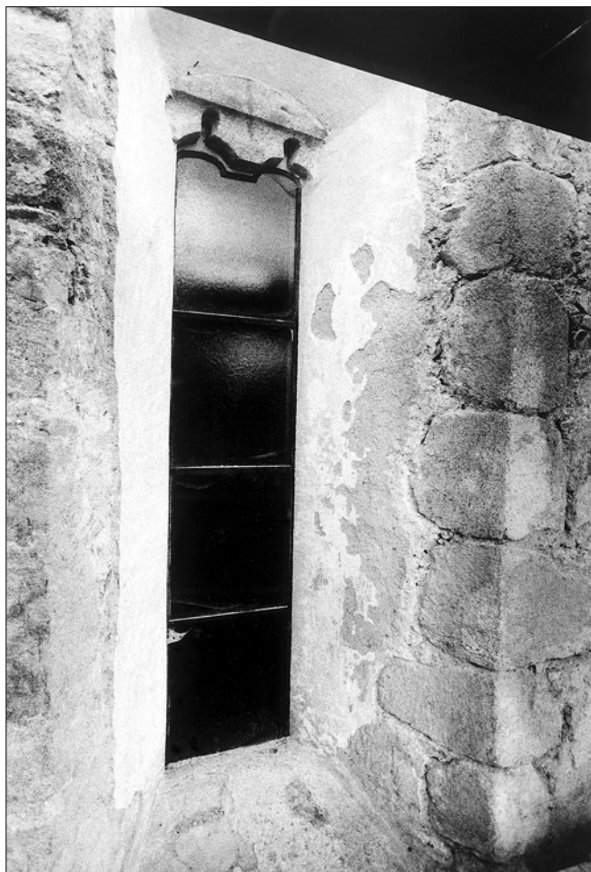
Obr. 14: Čížová, kostel sv. Jakuba Většího. Jižní stěna lodi. Východněji situované okno v době opravy omítek. Vpravo zachovaná původní kvádrová hrana románsko-gotické okenní špalety; levá strana přezděna v 17. století.
