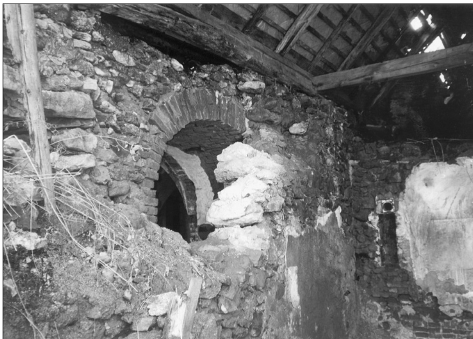
Obr. 9: Vyšší Brod, čp. 30, stav dvorního dílu hraniční zdi k sousednímu domu čp. 31 v r. 1997 (s přizděnou sousední arkádou).
