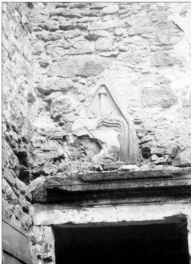
Obr. 15: Kuřivody, zámek. Nádvoří stěna západního křídla, druhotně osazený pozdně gotický reliéfní panel s berkovským znakem ve tvaru kolčého štítu zarámovaným ve vimperku (čelní stěna novodobě poškozena při pokusu o vyhlazení).
