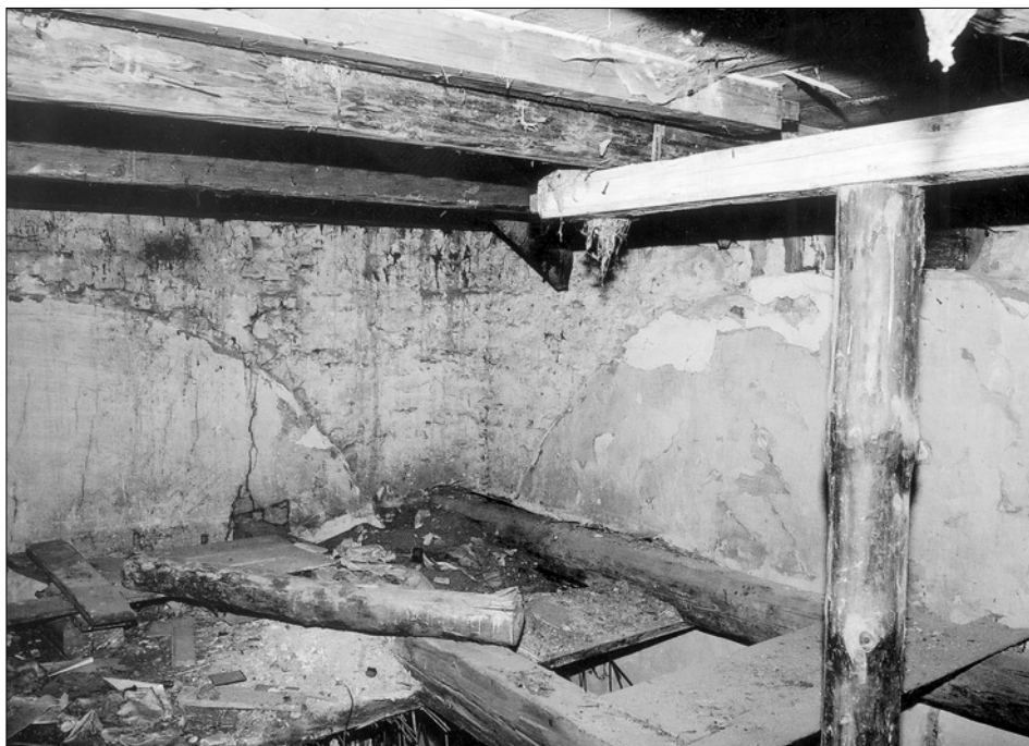
Obr. 18: Kuřivody, zámek. Východní místnost v přízemí jižního křídla, severozápadní roh. Mezi novodobým podhledem a podlahou patra jsou na stěnách zřetelně patrné otisky zbořených renesančních křížových klenby.
