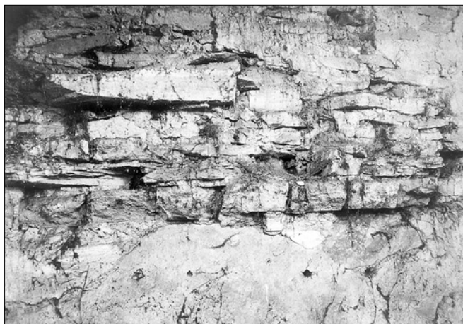
Obr. 18: Vraclav, dům čp. 115. Relikt odsekané římsy na východní stěně bývalé lodi kostela sv. Václava při jihovýchodním nároží, v patě střešního štítu (foto J. Sommer, 2001).
