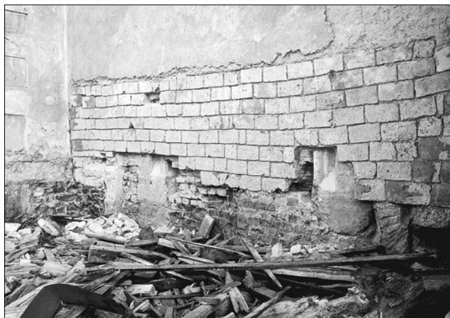
Obr. 3: Vyškov, kostel Nanebevzetí P. Marie, severní průčelí, obnažené sokly ostění zazděného gotického portálu (foto D. Čermoušková, 2000).
