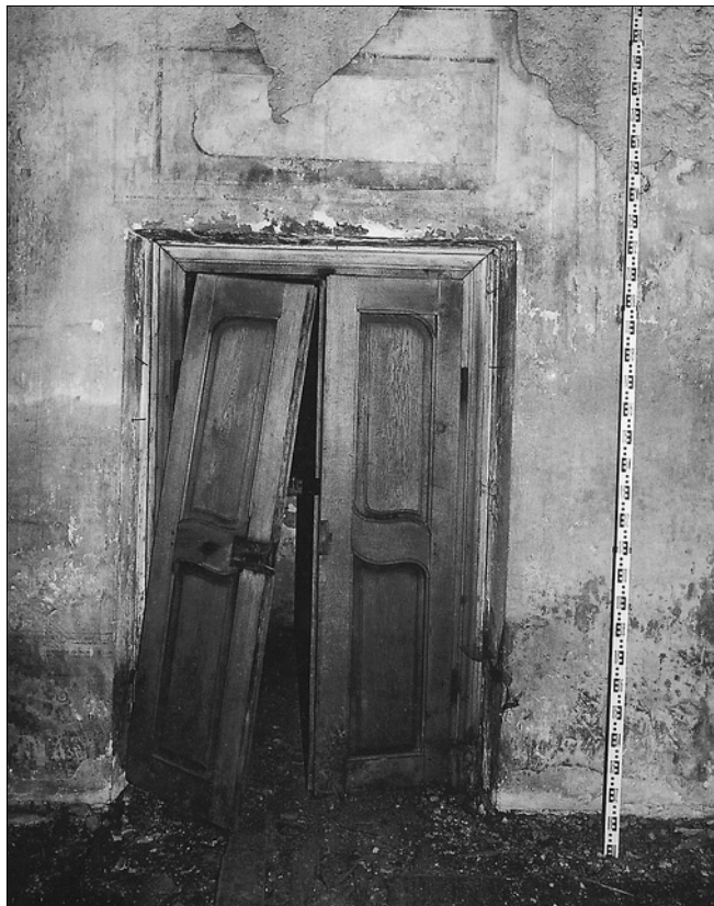
Obr. 18: Třebotov, fara čp. 1 – bývalá tvrz. Vstupní výplňové dveře do místnosti nad průjezdem (bývalé kaple), poškozené požárem. Okolo dveří se dochovaly zbytky dekorativní výmalby s rokokovou ornamentikou.
