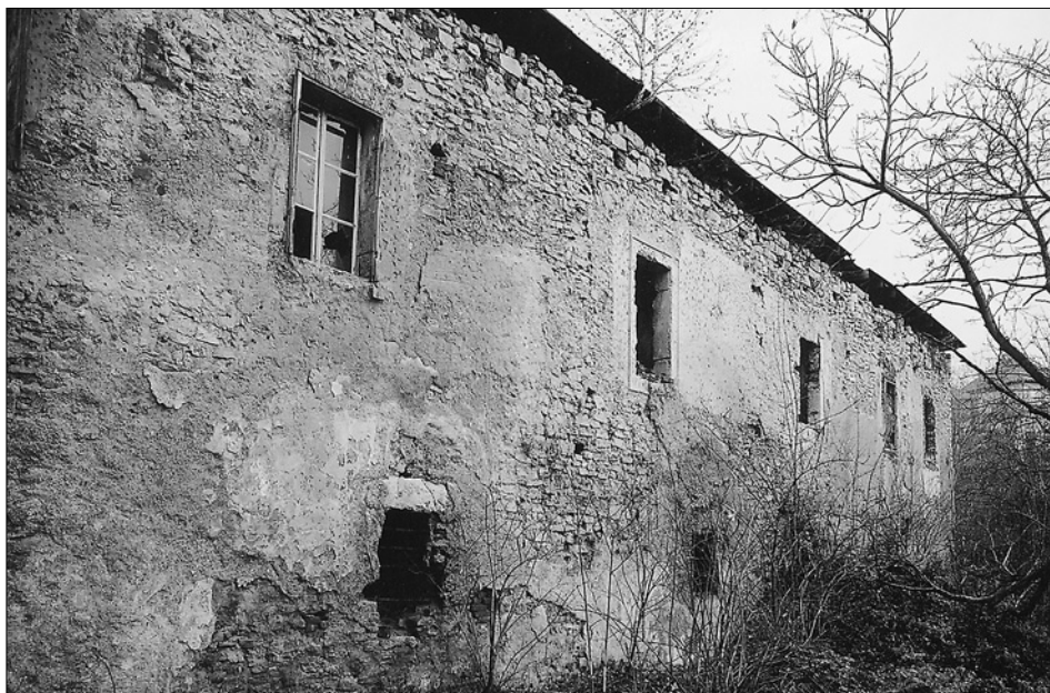
Obr. 10: Třebotov, fara čp. 1 – bývalá tvrz. Celkový pohled na požárem poškozené jihozápadní křídlo. Dnešní velká barokní okna patra nahradila stratigraficky starší okénka, z nichž se dochovaly záklenky a špalety.
