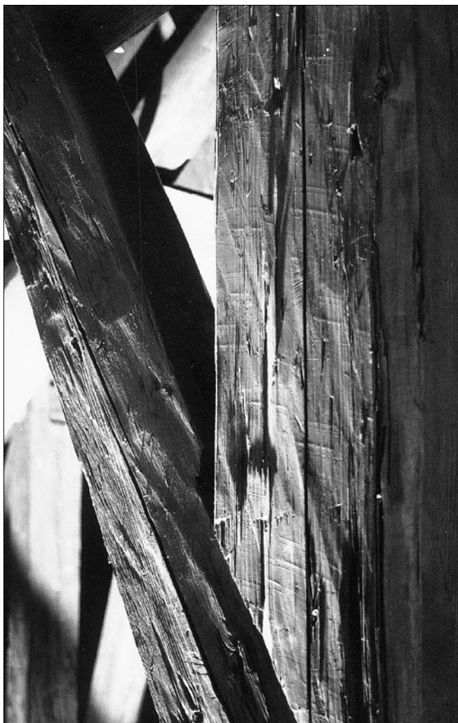
Obr. 28: Česká Lípa, kostel sv. Kříže, krov lodi. Centrální prostorová konstrukce, rám č. 2, sloup č. 19, detail tesařského opracování povrchu trámu v podobě stoupajících dlouhých mírně miskovitých prohlubní se stopami zanechanými poškozeným ostřím sekery, pohled od severovýchodu.
