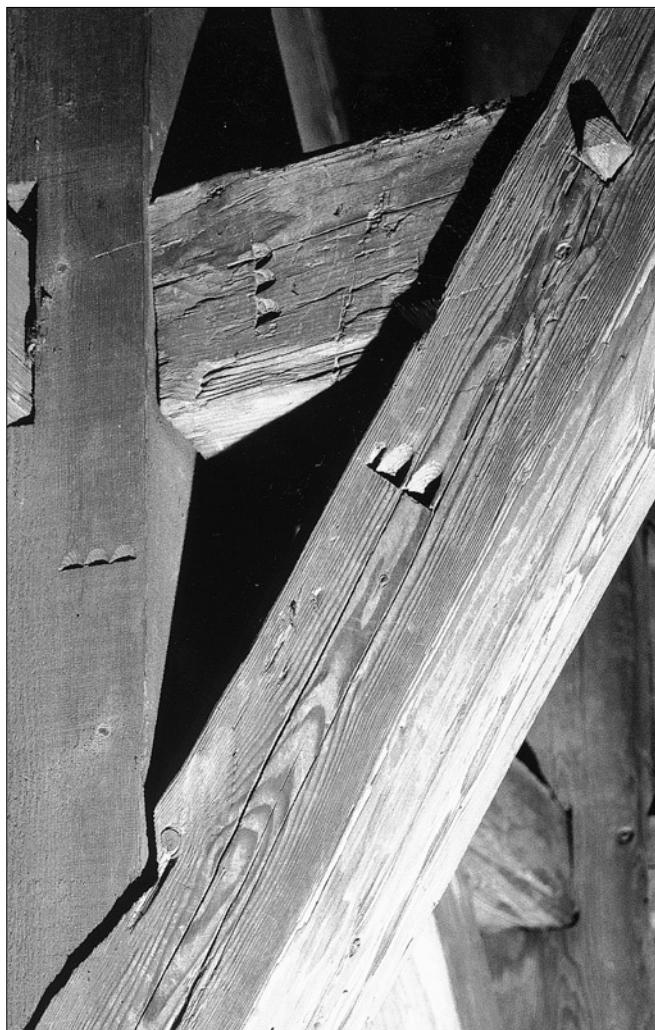
Obr. 30: Česká Lípa, kostel sv. Kříže, krov lodi. Centrální prostorová konstrukce, rám č. 3, sloup č. 10 a navazující západní rozpěra a šikmý prvek v první úrovni, detail původního a na novodobém sloupu druhotně doplněného tesařského značení, pohled od severozápadu.
