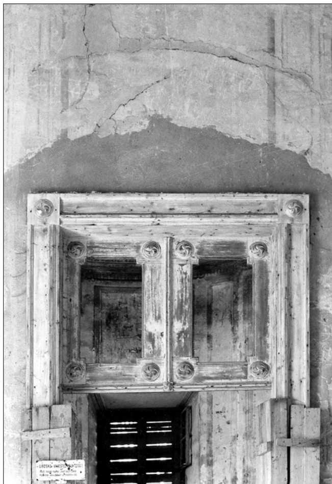
Obr. 25: Klasicistní dveře ze střední místnosti do oválu s patrnou trhlinou vyššího záklenku pro supraportu původně plánovaného portálu (foto P. Uličný, 2001).
