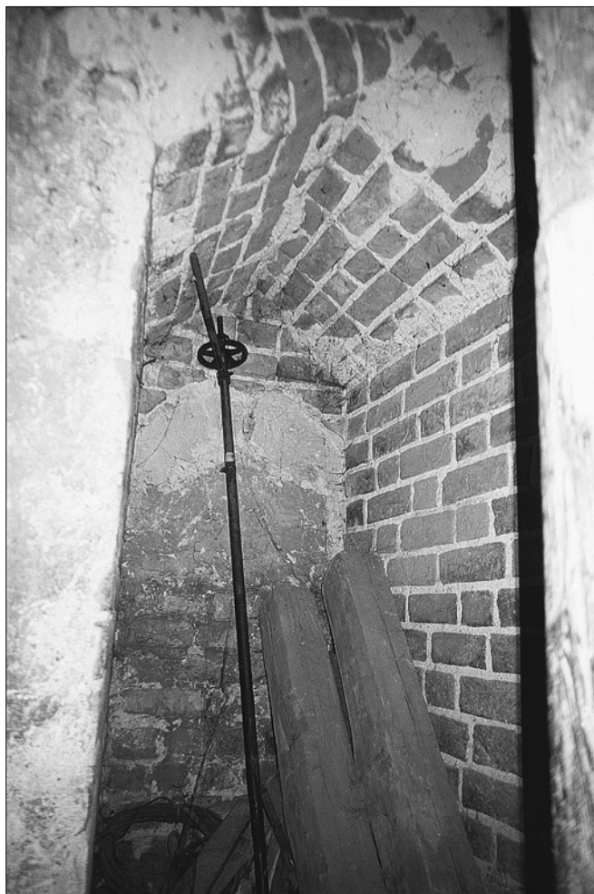
Obr. 26: Hlubčice, městský kostel Panny Marie. Raně gotický vstup z trojlodí do schodišťové věžičky, druhotně zaslepený po roce 1613, stav v roce 2003. Pohled od jihozápadu.
