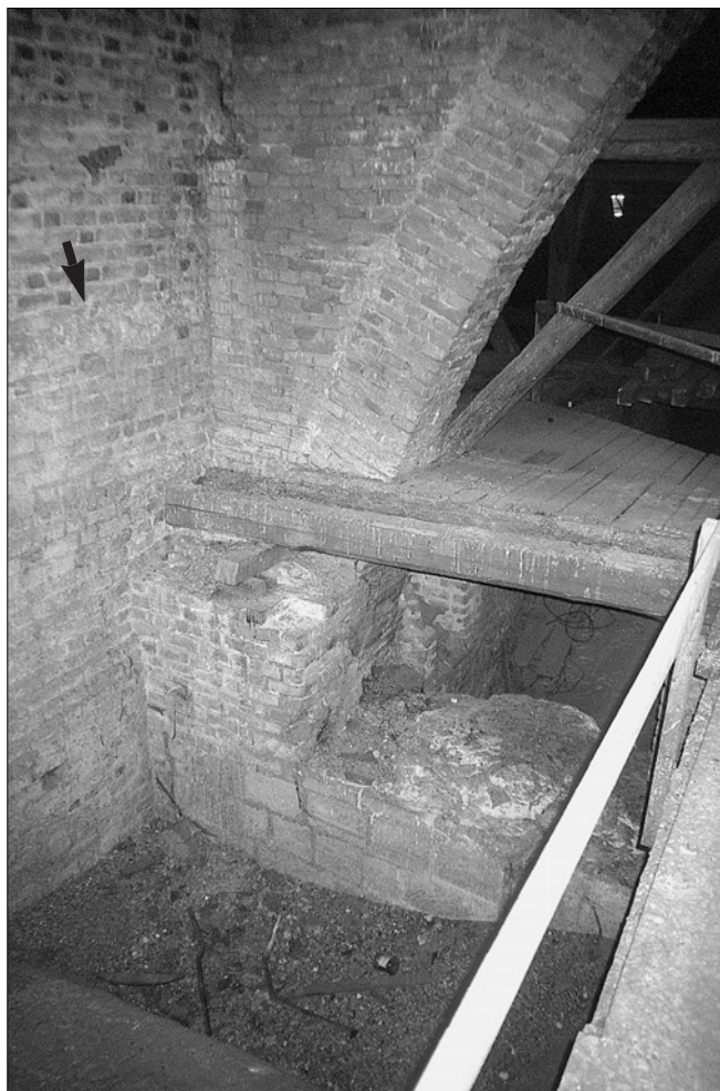
Obr. 40: Hlubčice, městský kostel Panny Marie. Severovýchodní kout mezi věží v podkroví, stav v roce 2003. Vlevo se zvedá jižní zeď severní věže s maltovým otiskem pultové střechy mírného sklonu z doby před novým přestřešením v roce 1826 (šipka), níže je patrné zdivo mezivěží z pískovcových kvádrů a torzo středověkého cihlového štítu, který v linii východních zdí věží uzavíral hlavní loď. Na ně neorganicky nasedá arkáda renesančního štítu, sekundárně přizdělá na spáru k nároží severní věže.
