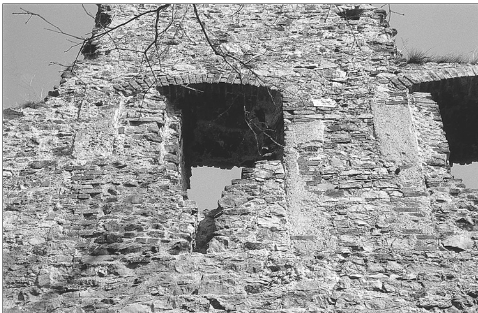
Obr. 11: Žebrák, hrad, dolní palác. Detail západního průčelí (srov. obr. 6), severní z trojice oken 1. patra. Na obvodu druhotně zazděných oken zbytky omítkové pasparty na cihelném ostění (snímek V. Razím, 2003).
