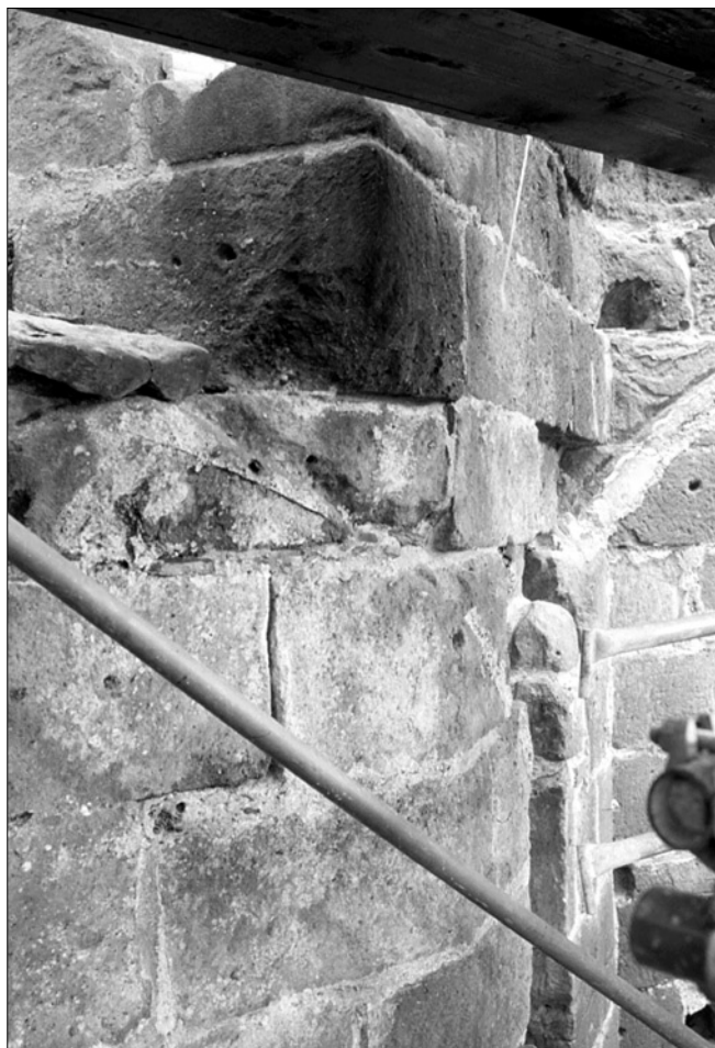
Obr. 50: Ojvíň, kostelní ruína. Východní polygonální kaple, detail odsekuté hrany opěráku v úrovni klenebních kápí (foto R. Němec, 2004).
