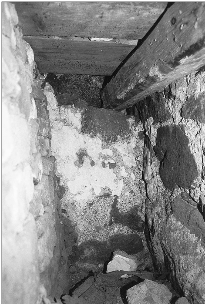
Obr. 16: Zahrádka, detail návaznosti stěn a starší omítky v rohu pod podestou schodiště. Zdivo pod úrovní nosníku podesty je v rohu provázané, starší omítka v rohu přechází formou rozmazané malty ve spárách a obílením (foto J. Veselý).
