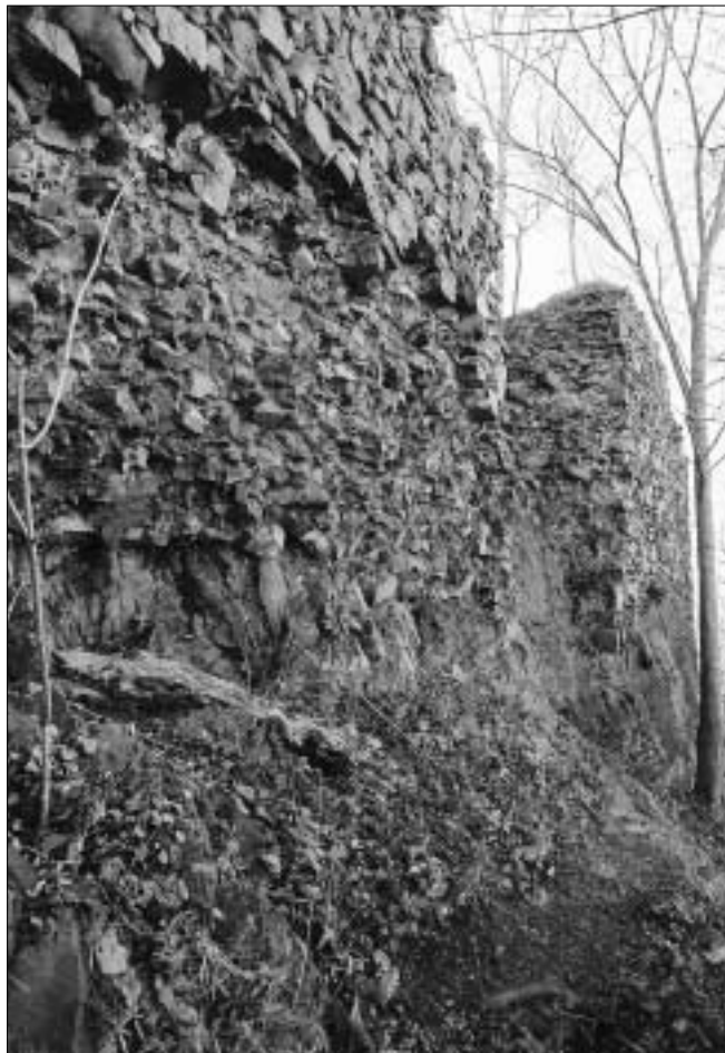
Obr. 17: Týřov, hrad. Vnější strana severní části hradby horního hradu, pohled od severovýchodu. V popředí zřícený líc, uprostřed proluka na místě zaniklé části hradby s obnaženým šikmým skalním podloží (foto V. Razím, 2004).
