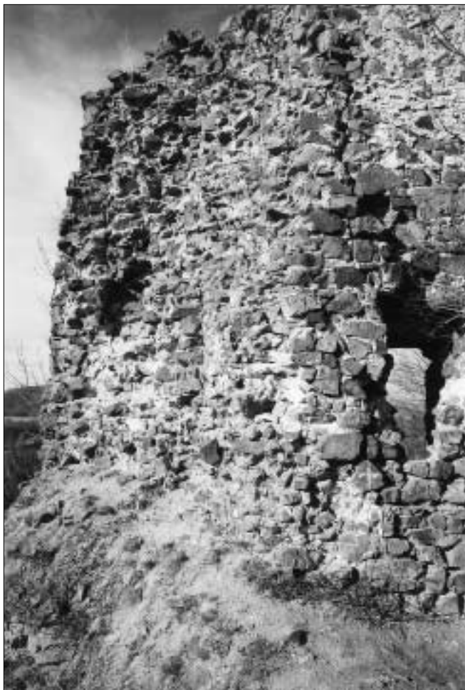
Obr. 14: Týřov, hrad. Věžový palác horního hradu, pohled od jihu do míst styku zaniklého jižního nároží s hradbou. Vpravo okénko přízemí s dřevěným překladem. Srov. obr. 13/3 (foto V. Razím, 2004).
