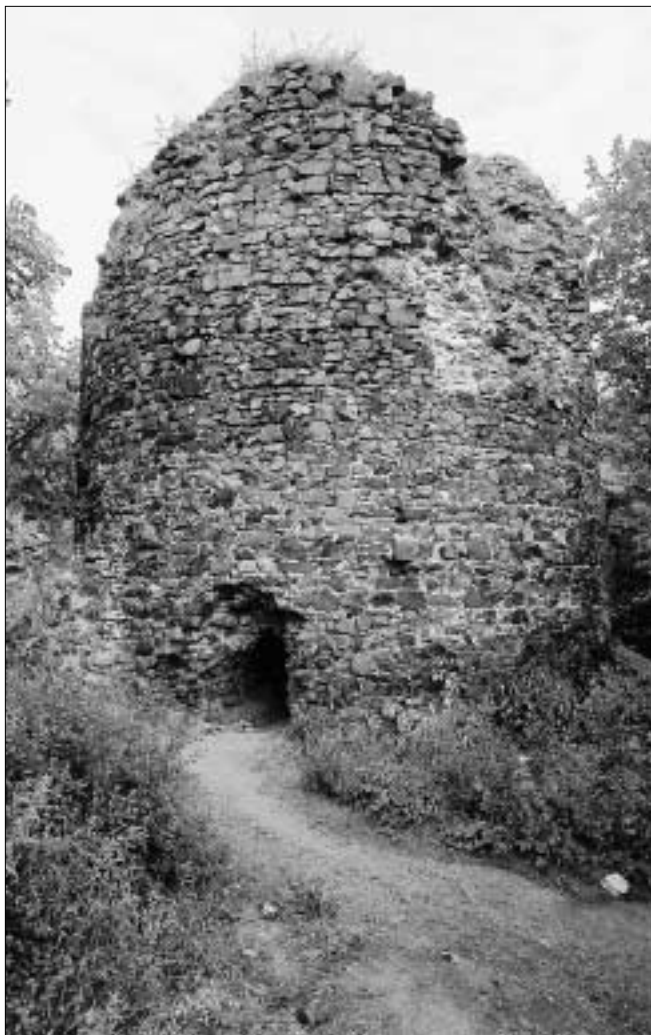
Obr. 9: Týřov, hrad. Válcová věž horního hradu, pohled od západu. Dole druhotně vylámaný otvor do přízemí, upravo nahoře vstup do 1. patra s destruovaným okolním zdívem (foto V. Razím, 2004).
