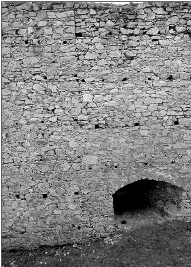
Obr. 38: Rabí, hrad, spára mezi jihozápadní kurtinou a jižní hradbou z vnitřního příkopu (foto J. Noll, 2005).
