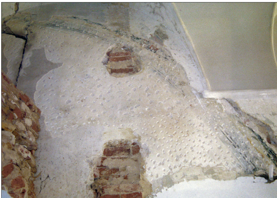
Obr. 2: Kostelec nad Černými lesy, zámek, první patro západního křídla, místnost č. 1, v úrovni pekované omítky nález malovaného arkádového oblouku patrně z poloviny 16. století a dále část zazděného okna (foto autorka).
