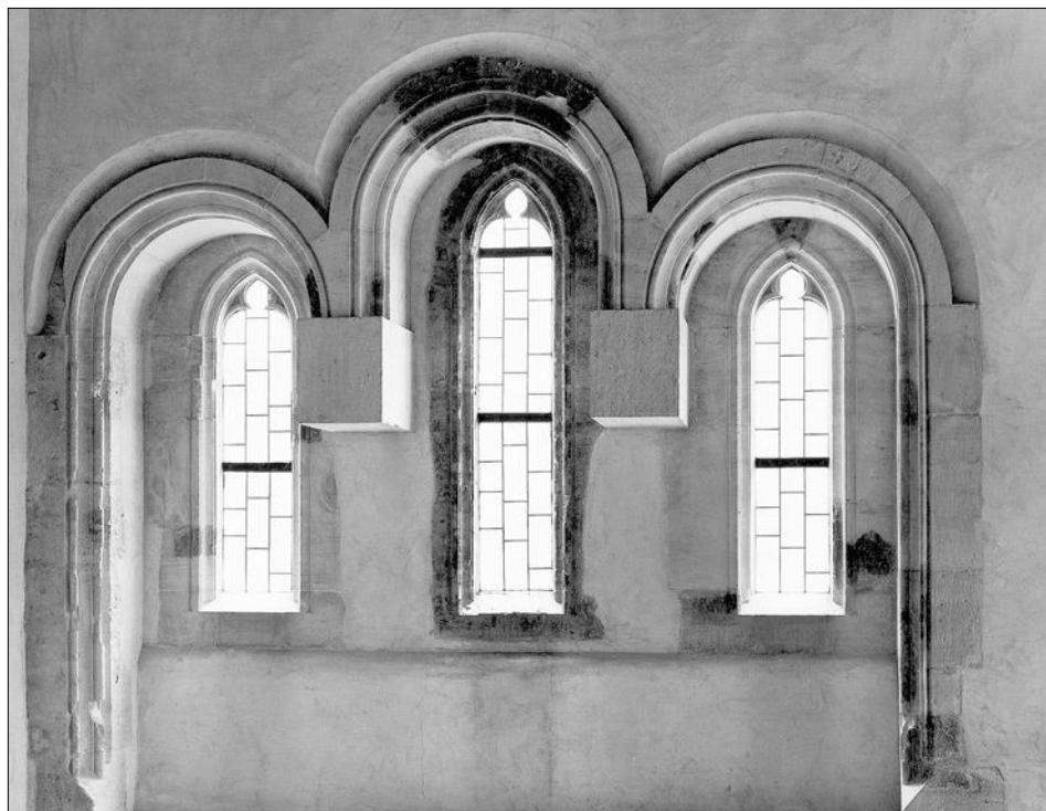
Obr. 36: Palác čp. 605. Trojdílný trůn Jana Lucemburského a regentů v jižní zdi na místě bývalého audienčního přístěnku (?) za sálem druhého patra. Před 1314 (foto G. Čapková).
