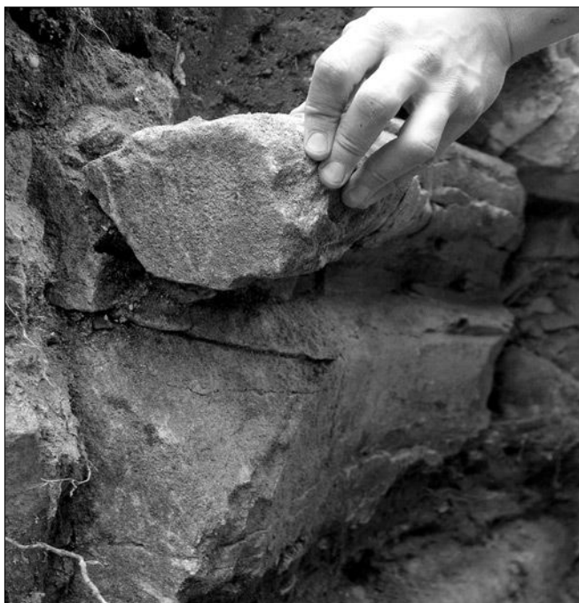
Obr. 9: Mělník – Pšovka, bazilika sv. Vavřince, rozpadající se pískovcový zlomek architektonického článku vyplňujícího prostor zaniklého gotického portálu.
