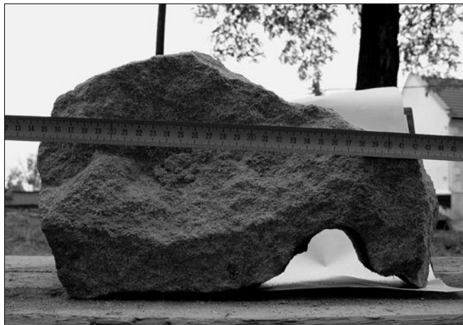
Obr. 11: Mělník – Pšovka, bazilika sv. Vavřince, rozpadající se pískovcový zlomek z ostění portálu.
