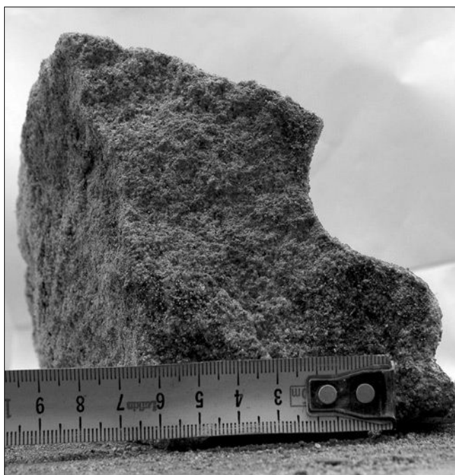
Obr. 12: Mělník – Pšovka, bazilika sv. Vavřince, rozpadající se pískovcový zlomek z ostění portálu.
