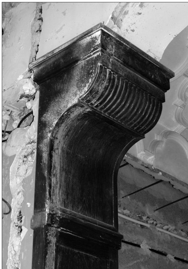
Obr. 3: Karlovy Vary, vila Becher, čp. 1196, dřevěná konzola stropu. Snímek ukazuje stav objektu v době realizace OPD a současně dokládá narušení památky dřívějšími nešetrnými zásahy (demontáž části výzdoby, málo ohleduplný způsob instalace elektrického vedení) (foto L. Zeman, 2005).
