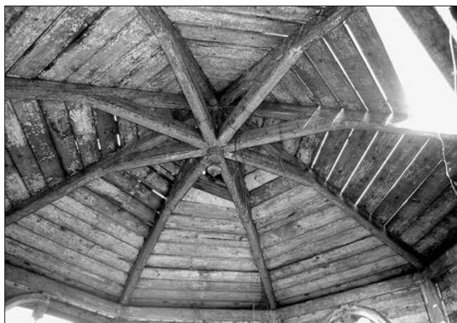
Obr. 8: Kutná Hora, dům čp. 261 – altán v zahradě, detail rozpadající se střešní konstrukce (foto J. Mrázek, 2005).
