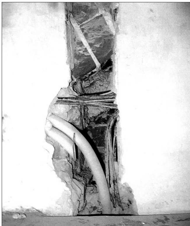
Obr. 12: Pardubice, arciděkanství, čp. 92, detail zásahu do omítek a zdiva v souvislosti s instalačními pracemi. Příklad významu sledování i zcela drobných zásahů, často odhalujících sice nevelké části konstrukce, avšak mnohdy s velkou vypovídací hodnotou. Je smutnou skutečností, že takových zásahů, jež by rovněž mohly přinášet poznatky o památkovém fondu probíhá každým rokem mnoho tisíc, avšak většinou bez příslušného zhodnocení z hlediska památkového výzkumu. Zachycení a vyhodnocení dílčích nálezů by přitom velmi často vyžadovalo pracovní nasazení jen v rozsahu několika hodin (foto F. R. Václavík, 2005).
