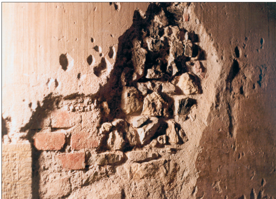
Obr. 12: Smrt Vratislava, destrukce omítek soklu pod obrazem.
