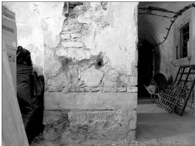
Obr. 24: Bečov nad Teplou, hrad, tzv. Pluhovské domy, přízemí 05, klasicistní pilíř klenby podstavený z raně renesančních dílů ostění, vpravo raně renesanční okno in situ.
