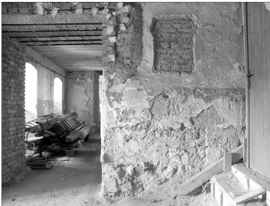
Obr. 21: Bečov nad Teplou, hrad, tzv. Pluhovské domy, přízemí 01, vpravo dole pravděpodobně středověká omítka u paty novodobého schodiště do patra.
