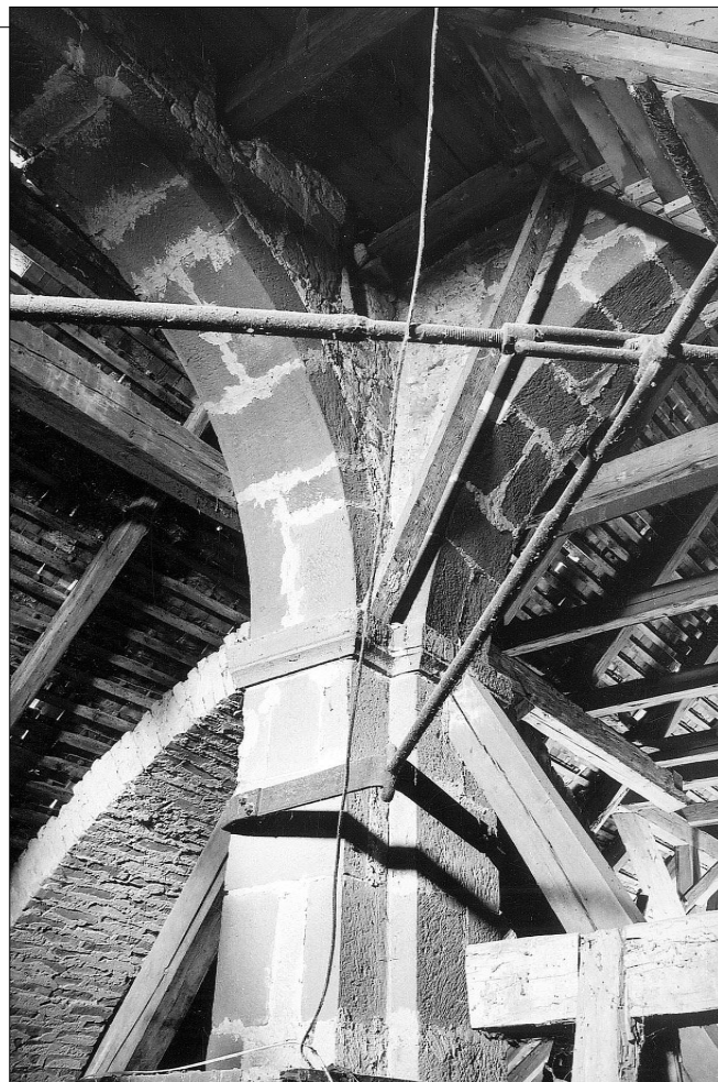
Obr. 8. Záboří nad Labem, kostel sv. Prokopa, pohled na jihovýchodní pilíř s výběhy pasů v podstřeší, vynášející zdivo věže. Vlevo cihelný, opěrný oblouk, zřejmě renesančního nebo raně barokního původu. Ocelová táhla v popředí pocházejí ze zajištění při výměně východní dvojice sloupů v roce 1933 (foto J. Žížka).
